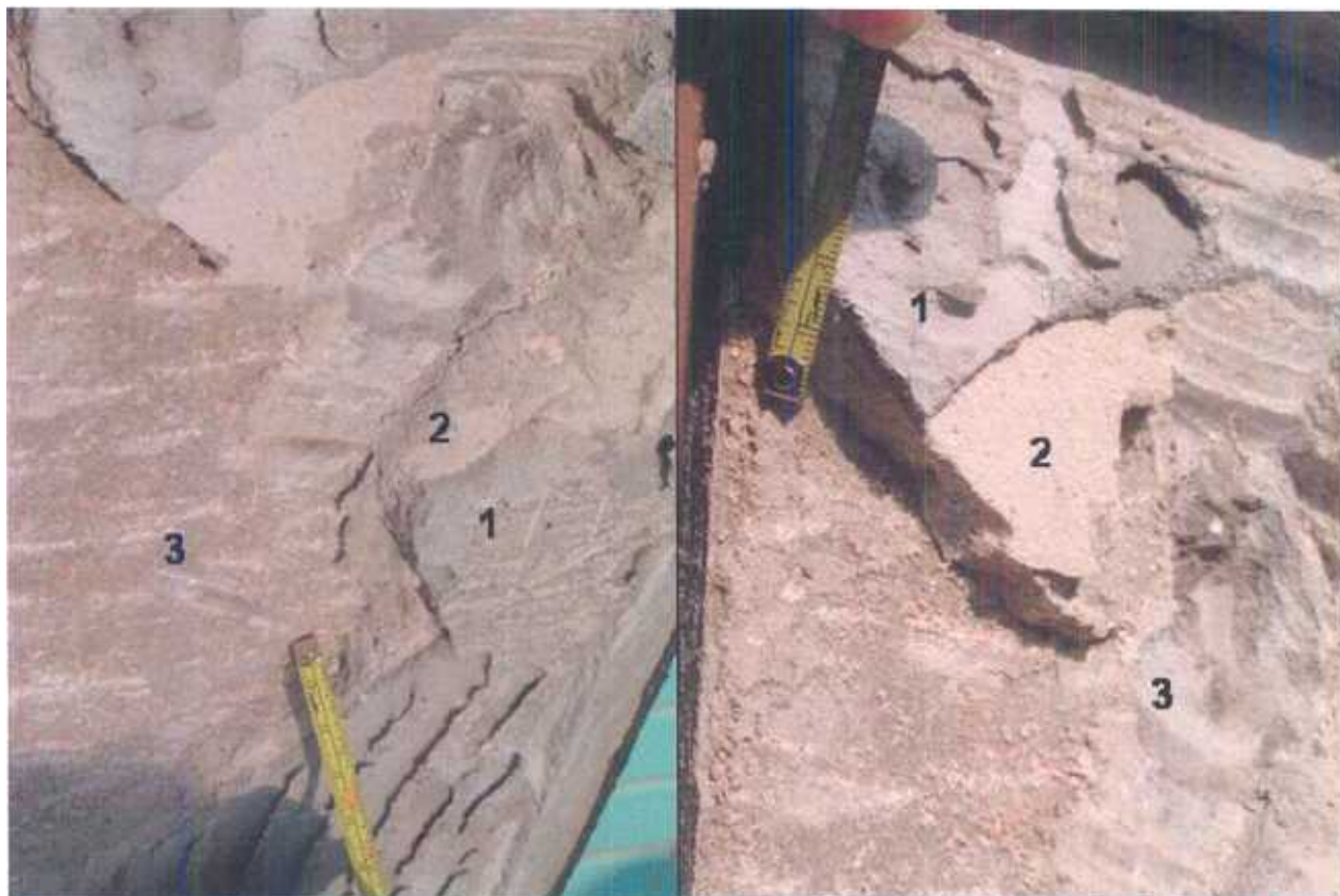
Fotografia 5 – Detalhe da base mostrada na Fotografia 4, após pequena destruição, mostrando os diferentes constituintes: 1 – Argamassa de emboço; 2 – Argamassa colante; 3 – Base resistente (argamassa forte ou concreto)
