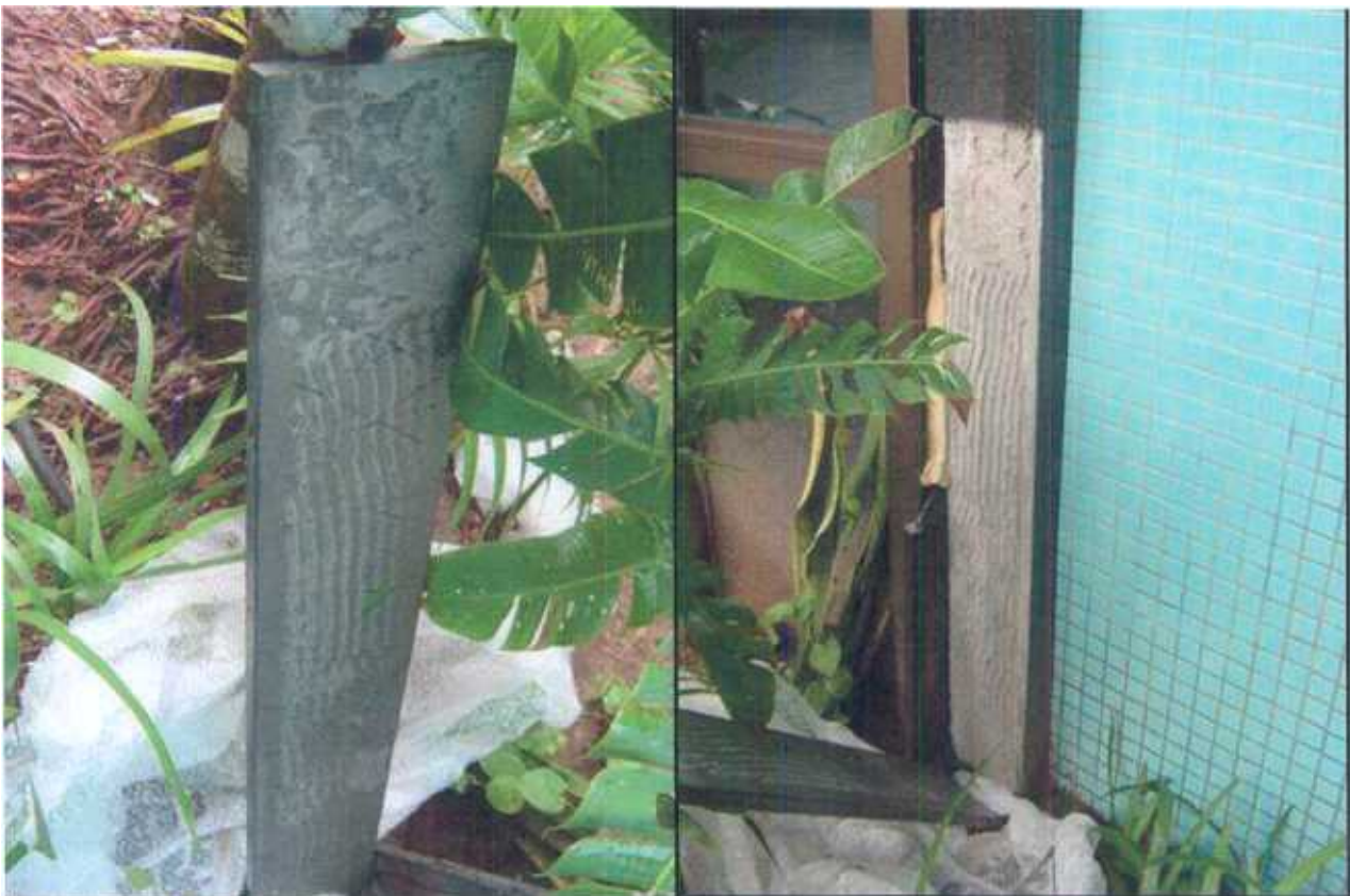
Fotografia 3 – Tardoz da peça de granito intencionalmente descolada do pavimento térreo do prédio, na fachada Sul.
