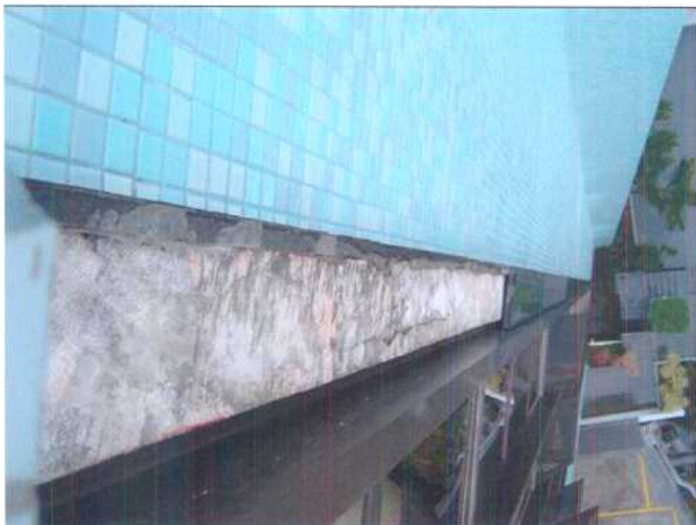
Fotografia 2 – Suporte da placa de granito desprendida.
